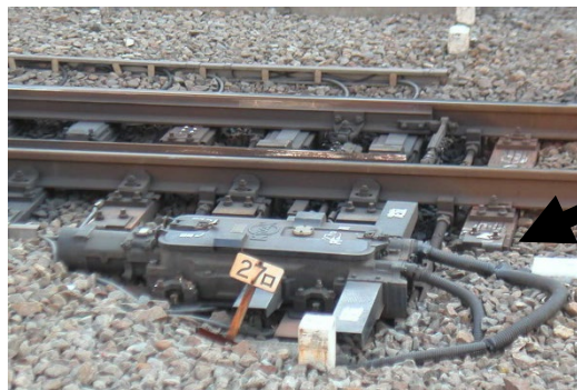
転てつ機 (線路の切換機)
