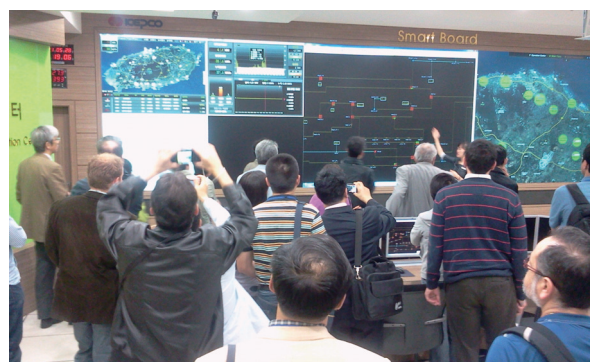
図2 (写真) 済州島スマートグリッドの中央監視室 (KEPCO)
