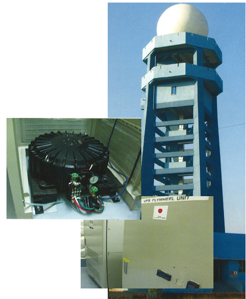
図 1 気象レーダ・タワーと FW-UPS の外観
