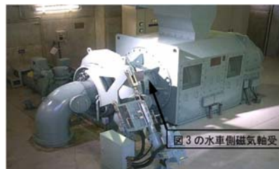
図2 赤川発電所の水車・発電機の全景
