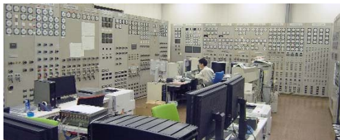
電力系統シミュレータ制御室
